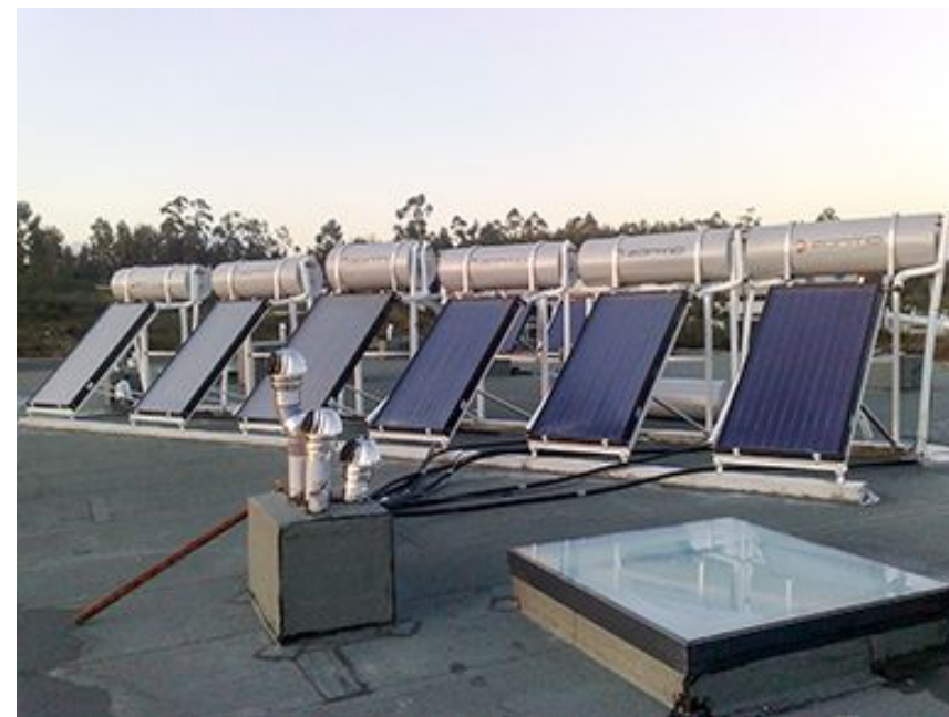
Painéis Solares Térmicos
